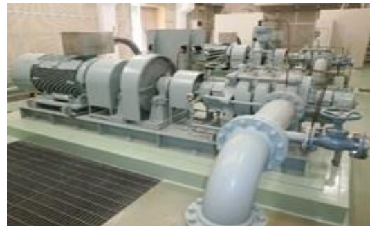
《高効率電動機採用のポンプ設備》
