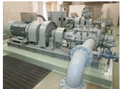
《高効率電動機採用のポンプ設備》
