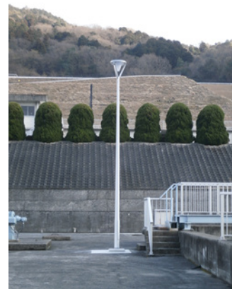
《高陽浄水場外灯設備》
