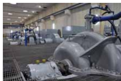
取水場のポンプ
