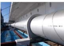
▲国道2号（江波大橋）に架けた広島南配水幹線
